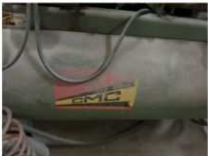
Compressore ad aria trifase CMC del 1977
